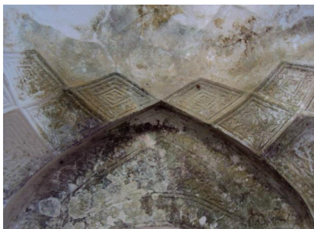
نفوذ خزّه و جلبک به سقف‌ها و دیوارهای حمام کیدیچی
